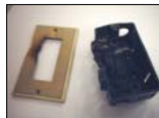
スイッチプレートとボックスが焼けて変形している。
